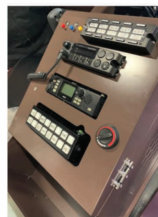
16スイッチコントローラー 埋込設置
